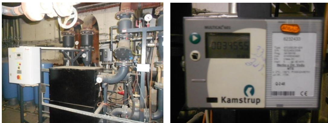
Slika 3. Toplotna podstanica sa meračem toplotne energije u objektu Uprave grada
